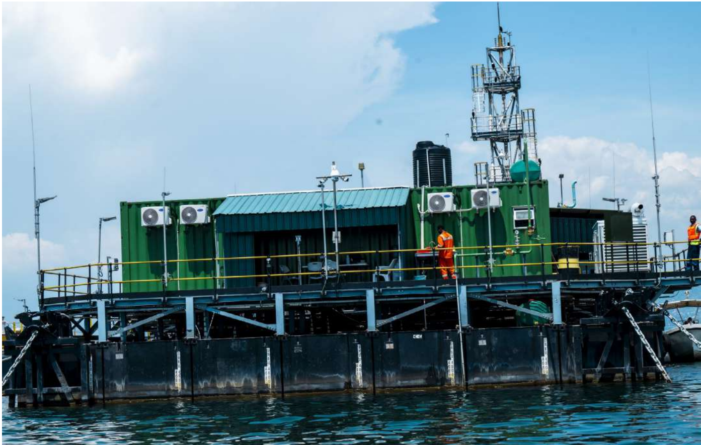
MININFRA yatangaje ko kuva muri Gashyantare 2024 kuva uruganda rucukura gaze methane rukora neza kuko rutanga Megawatt 56
